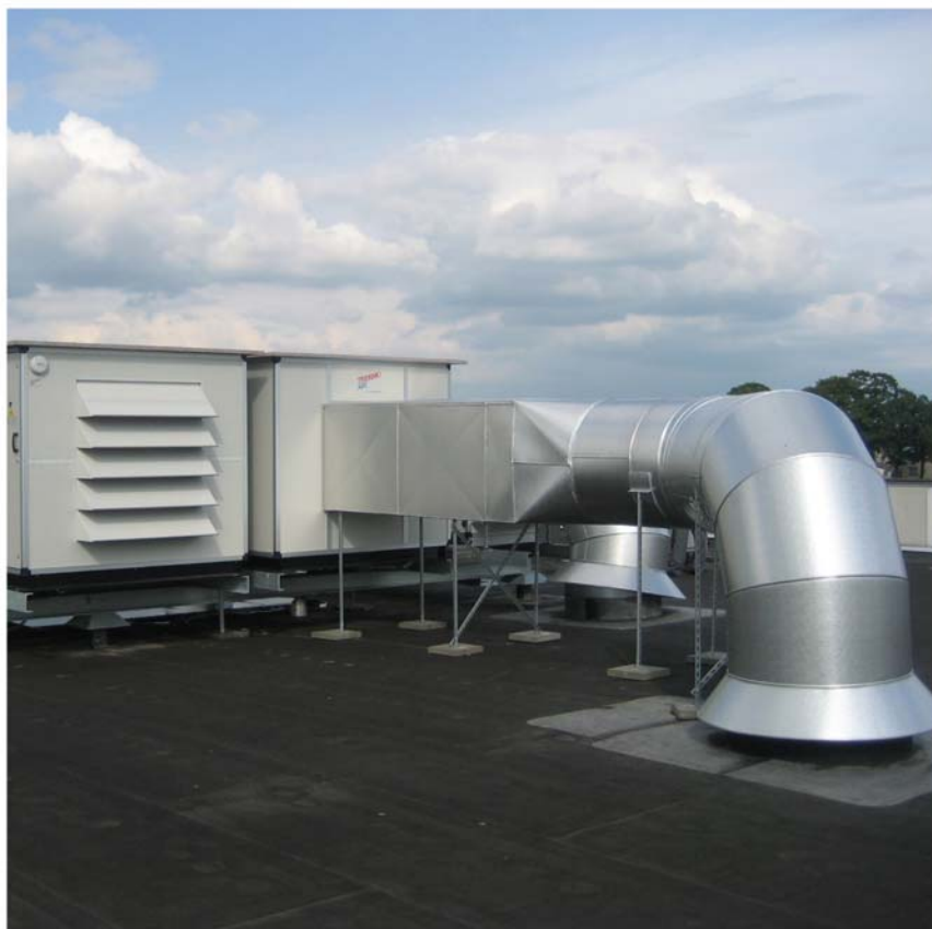
Foto Luchtbehandelingsinstallatie, fabriek Thermo Air, voorzien van StatiqCooling en WTW
