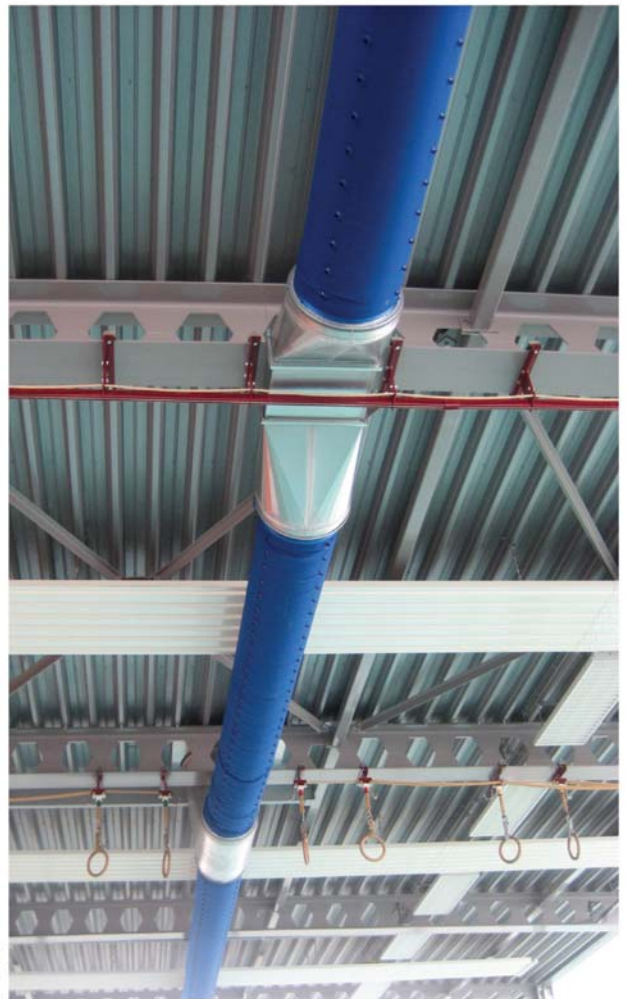
Foto 2. Flexibel luchtkanaal op zes meter hoogte onder het plafond voorzien van uitblaasnozzles.
